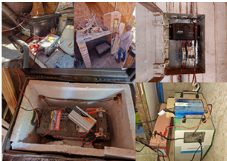
Figura N° 7: estado de las instalaciones del programa
