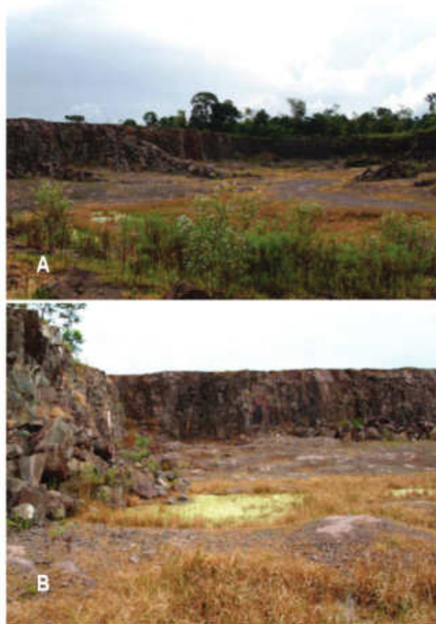
Figura 6. Ex Cantera NECOM, sobre RP N°11 en 2 de Mayo, inactiva hace 5 años. A. Dentro de la cantera se observa ausencia de suelo y compactación, escasa vegetación y rocas sueltas. B. Frentes inestables y anegamiento.
