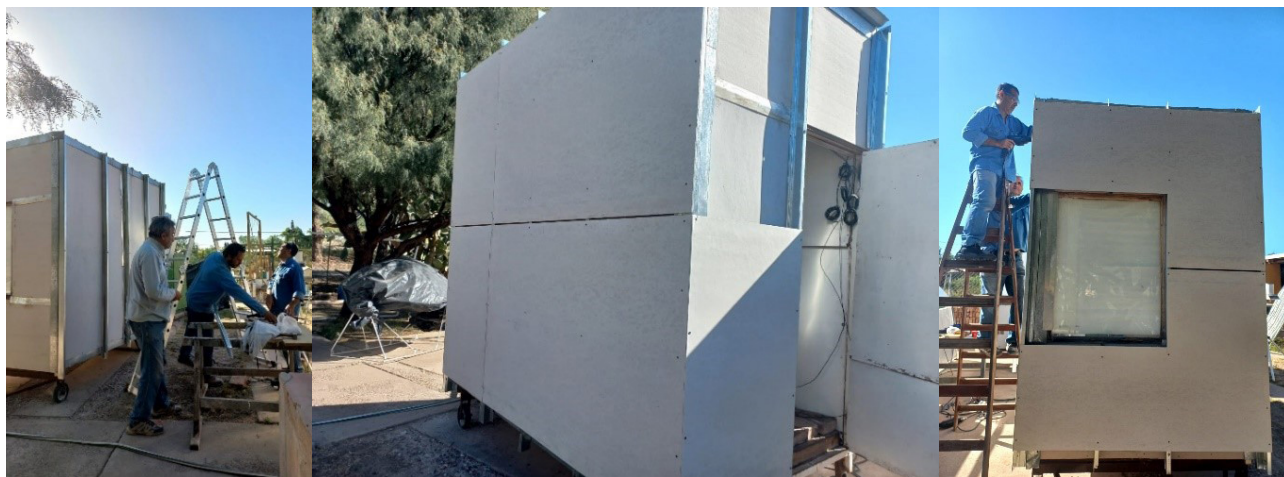
Fig. 3: Box intervenidos con cámara ventilada y segunda piel
