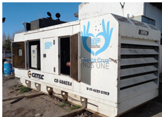
Fig. 10 Generador diesel CETEC / SPSE Lago Posadas
