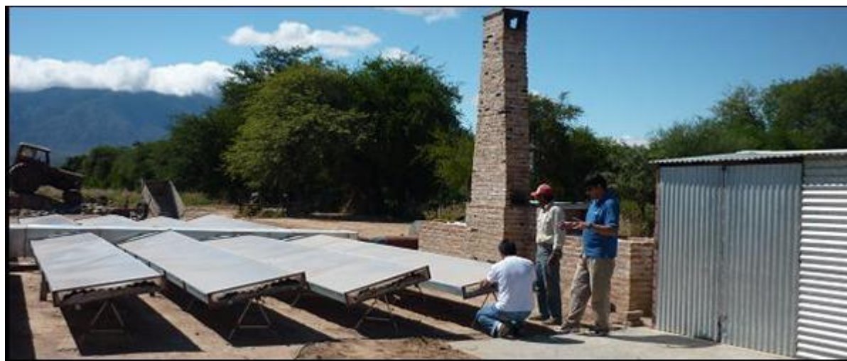
Fig. 2: Fotografía del secador. Vista lateral este – oeste, con colectores dirigidos al norte.
