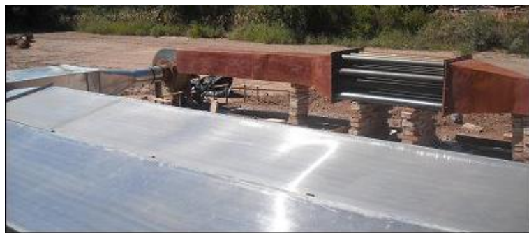
Fig. 5: Detalle del intercambiador de calor y banco de colectores.
