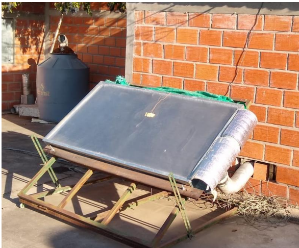
Fig. 11: Colector en operación y toma de datos de temperaturas y variables meteorológicas.
