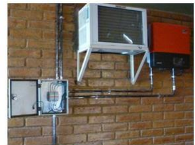
Vista Instalación de Interior
