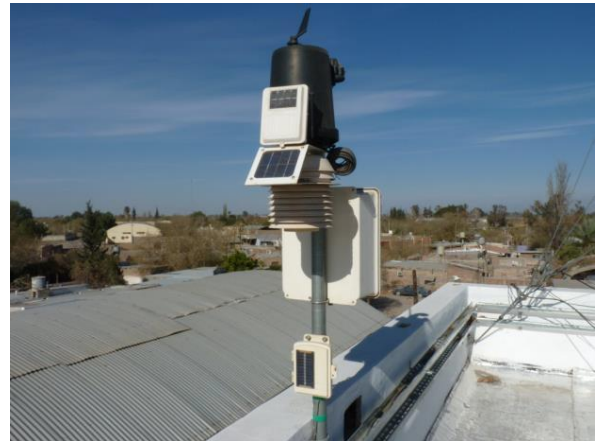
Fig. 6: Estación Meteorológica instalada en la sede de DECSA. Instalación Fotovoltaica Realizada en la Vivienda
