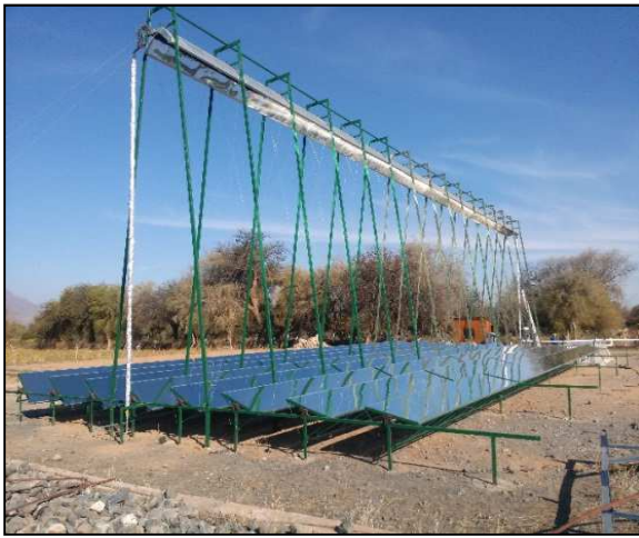
Fig. 1. a): Imagen del LFC instalado en San Carlos, con un área de 173m 2 .
