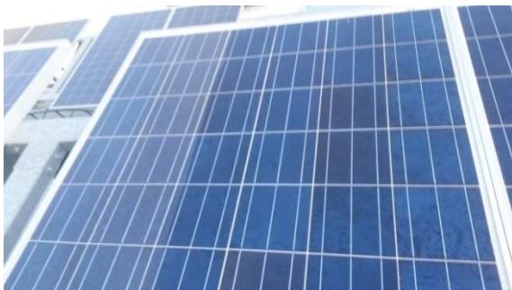
Fig. 6: Panel parcialmente limpio.
