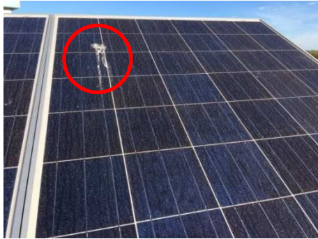
Fig. 4: Ejemplo de suciedad en un panel solar (deposiciones de aves y polvo acumulado) (A).
