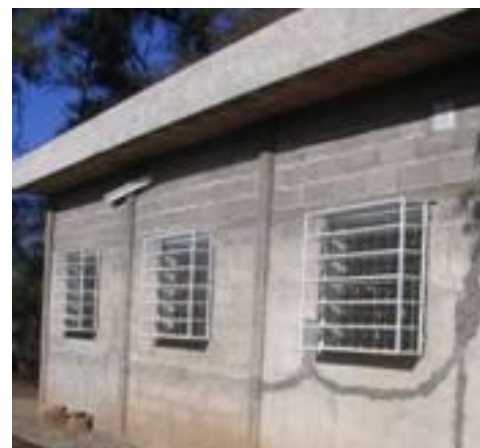
Foto 5.- Ubicación de los estantes de luz en ventanas de la fachada norte.
