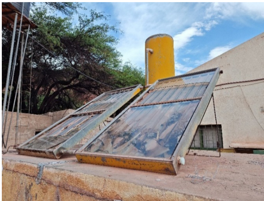
Figura 9: calefones solares deteriorados. Fuente: banco propio de imágenes.
