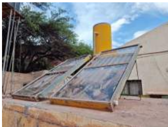
Figura 10: calefones solares deteriorados.
