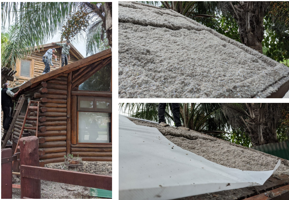
Figura 9: Proceso de colocación de celulosa en cubierta y lámina de membrana aislante hidrófuga. Fuente: E.P.
