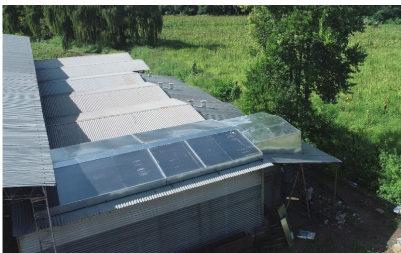
Figura 6: Fotografía aérea del sistema propuesto ya instalado en los techos de la estufa. Calentadores solares y envoltura a la unidad de calor.
