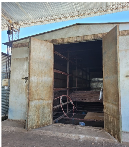
Figura 2: Vista del frente de carga y descarga de la estufa, se observan la estructura de rack para los cuatro niveles de peines.
