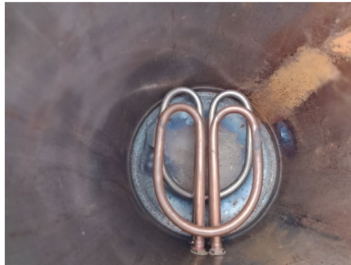
Figura 2: Sistema de calentamiento con resistencias de ACS
