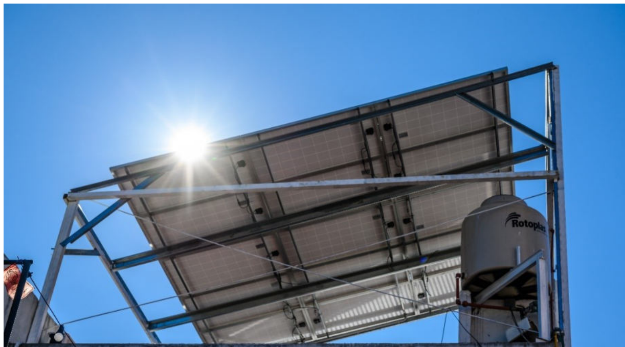
Figura 2: Módulos FV montados sobre una estructura elevada.
