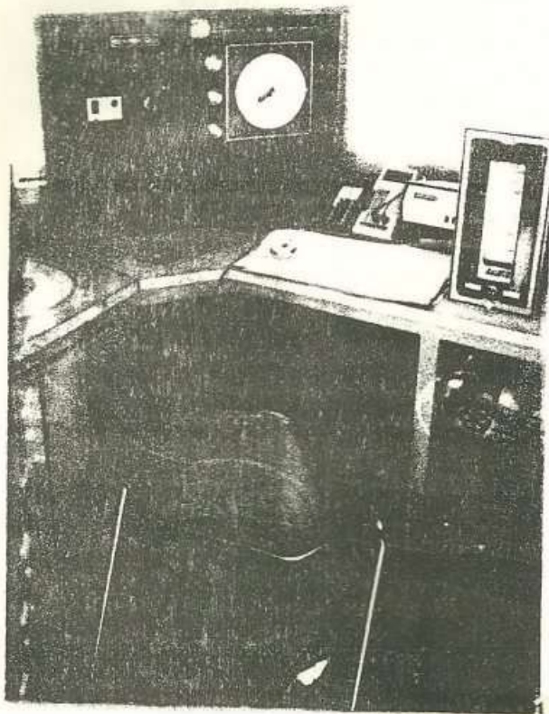
Vista interior de cabina de Mediciones
