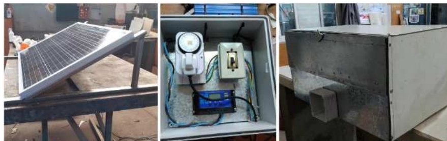
Figura 4: Izquierda. Panel solar y estructura de soporte. Centro. Gabinete de comando, control de carga/descarga de batería y conmutación Solar/220V red. Derecha. Gabinete UVC.
