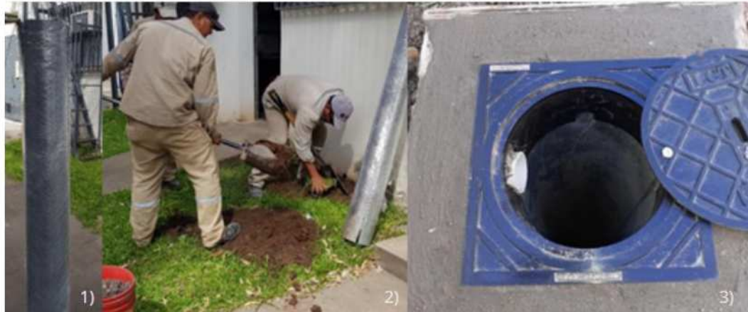
Figura 2. Perforación y colocación de sensores. 1) Conducto para protección de sensores. 2) Realización de la perforación. 3) Perforación con sensores
