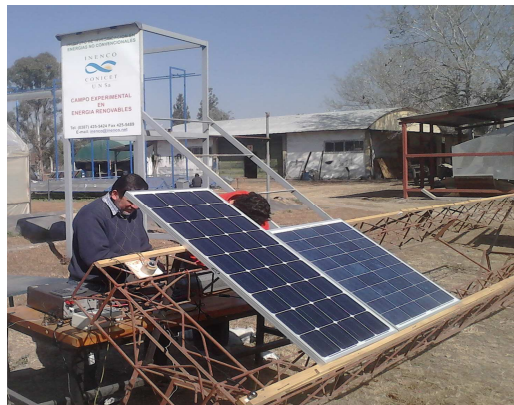
Figura 2: Módulos de dos tipos diferentes, montados en la estructura soporte.
