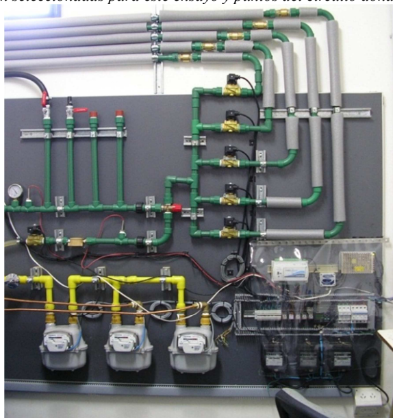
Figura 3: Fotografía del tablero de medición y control
