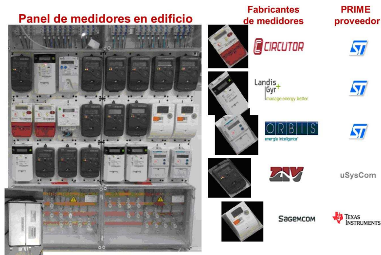
Figura 7: panel de medidores de un edificio con tecnología PRIME (Arcauz N. y Larumbe I, 2010)
