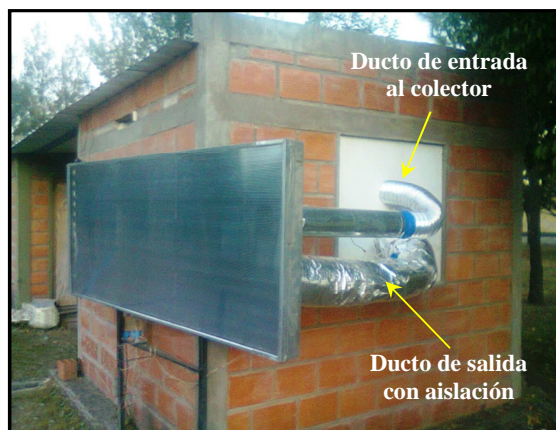
Figura 3: Colector solar conectado al prototipo de edificio.
