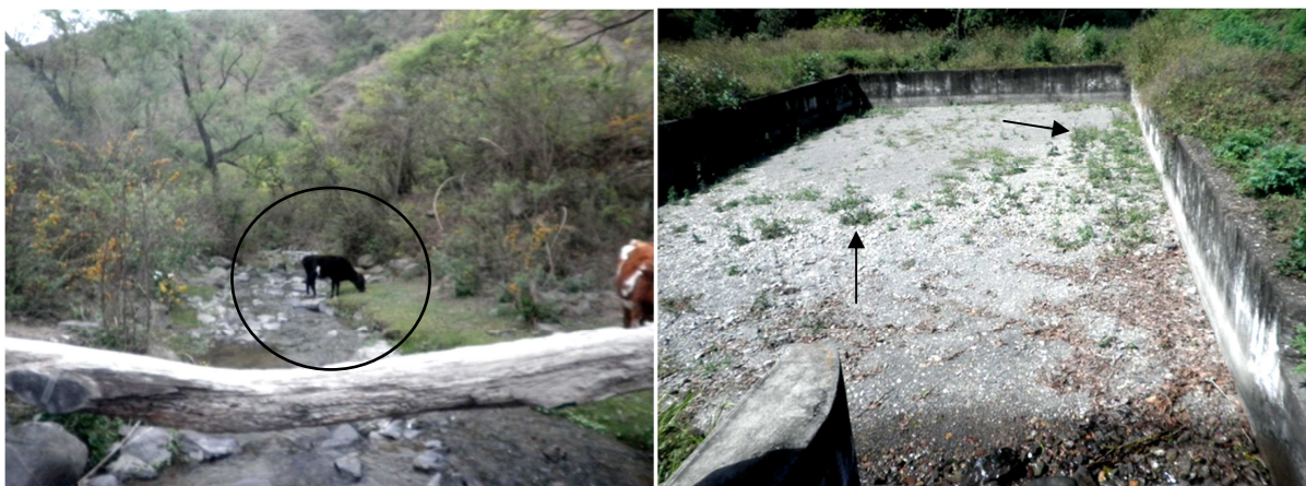
Figura 9. Animales dispersos en la cuenca de captación de agua (izquierda). Cámara de filtrado invadida por vegetación (derecha).
