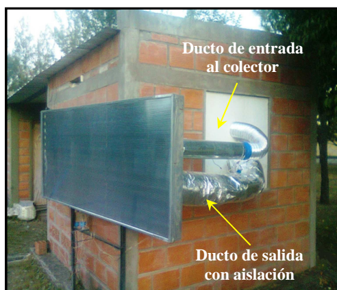
Figura 2: Colector solar conectado al prototipo de edificio.
