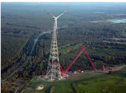
Figura 6 - Torre reticulada de 160 m de alt.; Laasow, Alemania (2,5MW- SeeBa)
