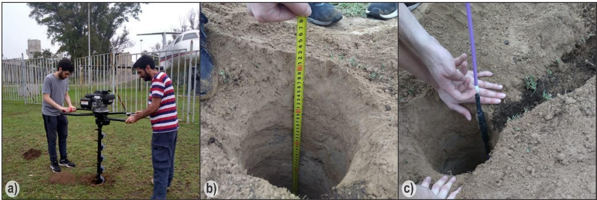
Figura 1: Ejecución de la perforación y colocación de sensores. (a) Utilización de hoyadora (b) Profundidad de la perforación (c) Colocación de sensores.
