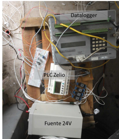
Figura 4 Sistema de automatización con PLC, fuente y adquisidor de datos.
