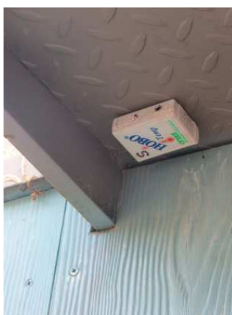
Figura 5. Ubicación del sensor exterior
