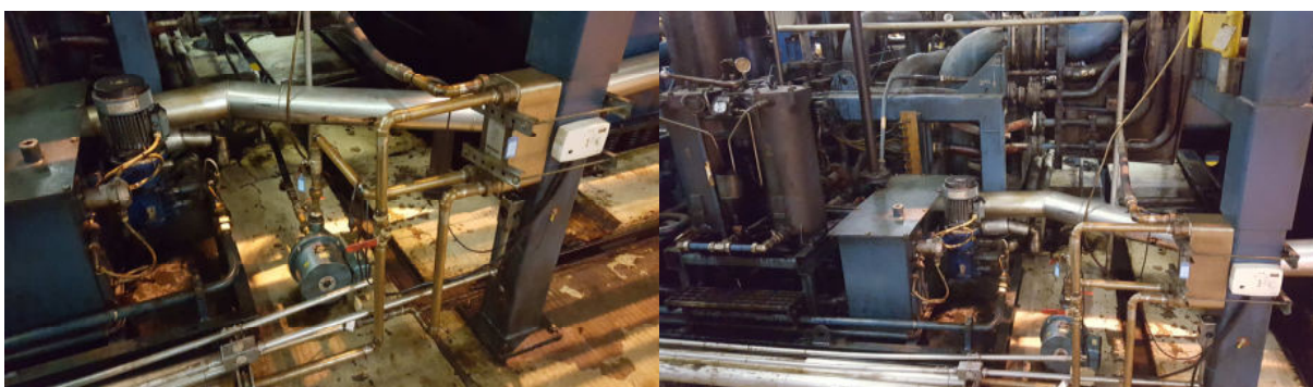
Figura 8: Sistema de trocador de calor de 5.000 litros.
