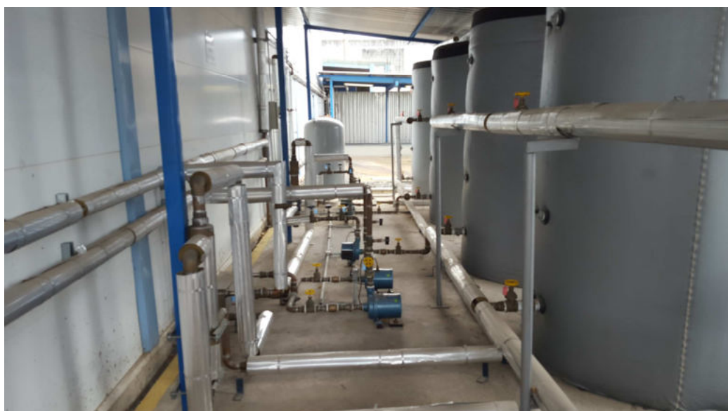
Figura 7: Sistema de Armazenamento.
