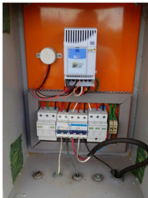
Figura 7: Quadro elétrico contendo o conversor de frequência e dispositivos de proteção.
