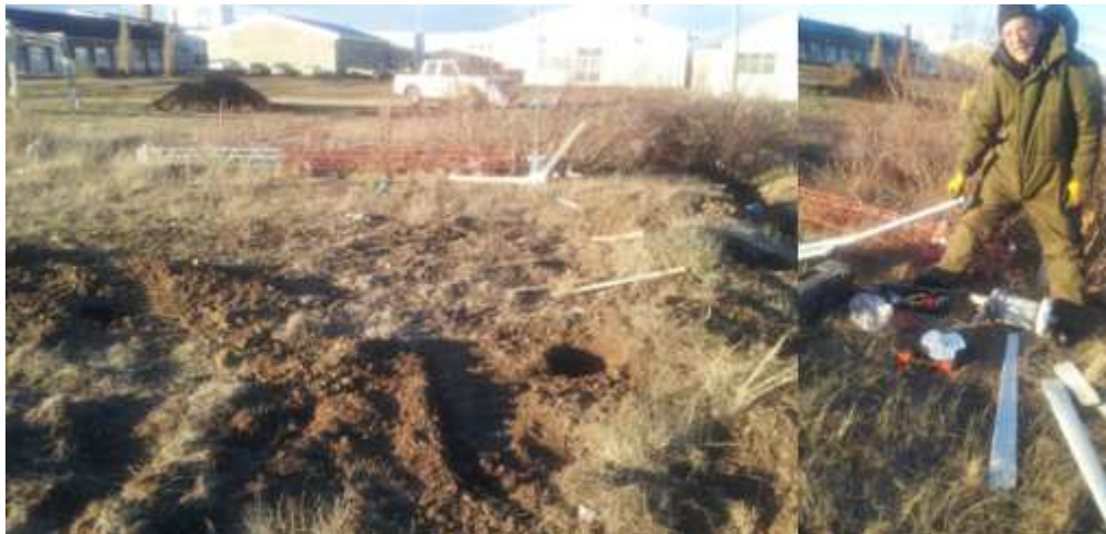
Figura 4: Torre derribada accidentalmente durante la construcción del cerco perimetral (07/2015)
