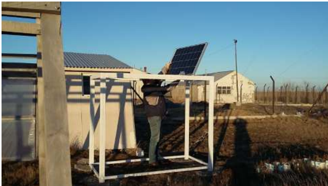
Figura 8: Ubicación aproximada del juego de paneles fotovoltaicos sobre soporte elevado, en preparación
