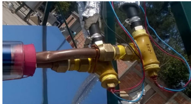
Figura 13: Sensores de temperatura en la entrada y la salida del flujo.
