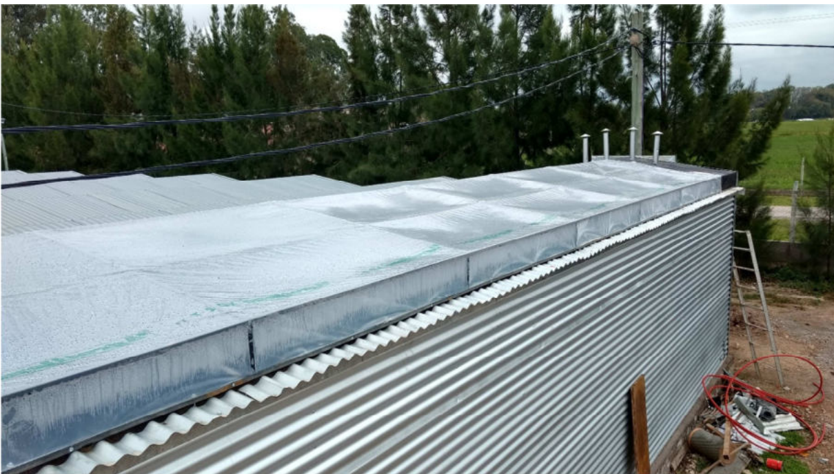
Figura 4: Sistema de colector solar en el techo de la estufa mejorada. Cubre el sistema de recuperación de calor.
