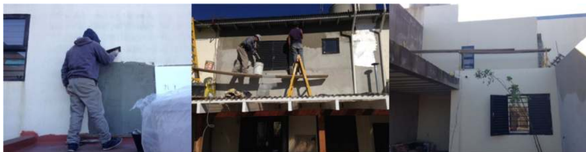
Figura 4: imágenes de la ejecución de la obra de aislación exterior de muros.
